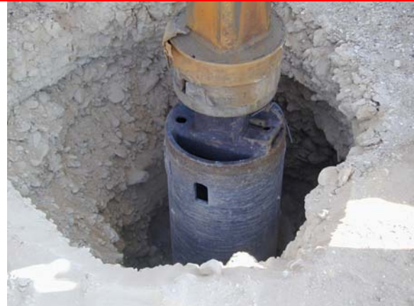
קדוח ק-1, מפני השטח ולעומק 2.0 מטר התמוטטות דפנות יוצרת הרחבה של הקדח (קוטר כ-1.2 מטר בסמוך לפני השטח).
